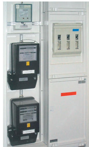
BHKW-Modul und Zählerkonfiguration
